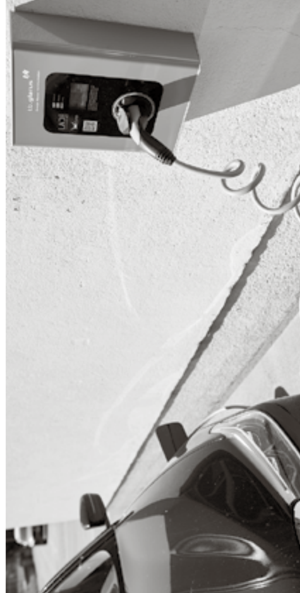
Ladestation an der Ennetbühlerstrasse.
