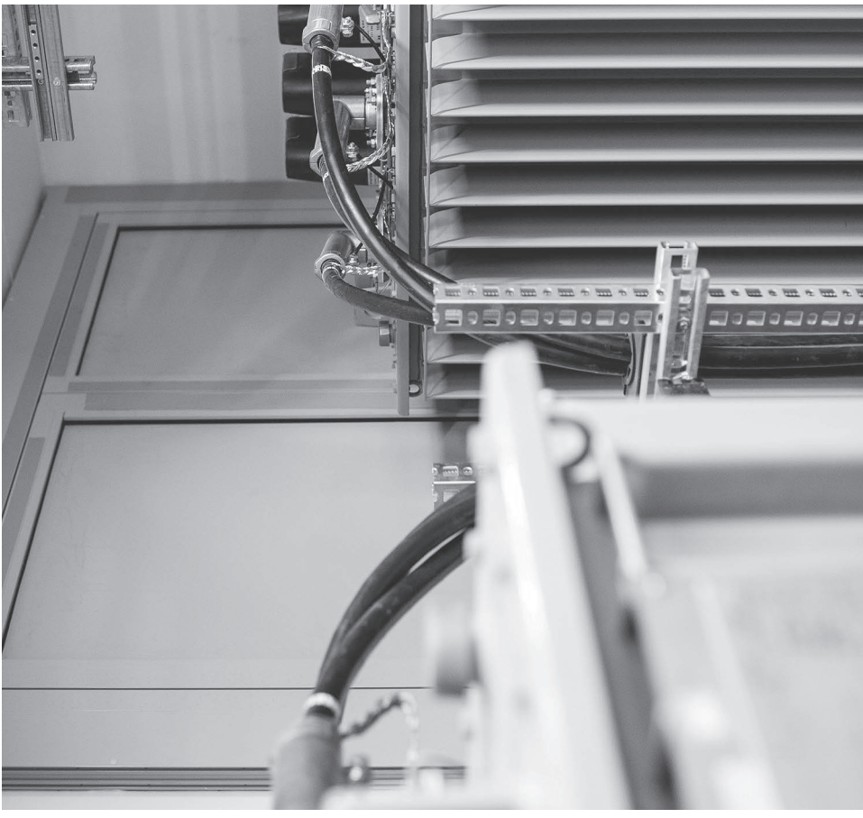
Sanierte Trafostation in Glarus.
