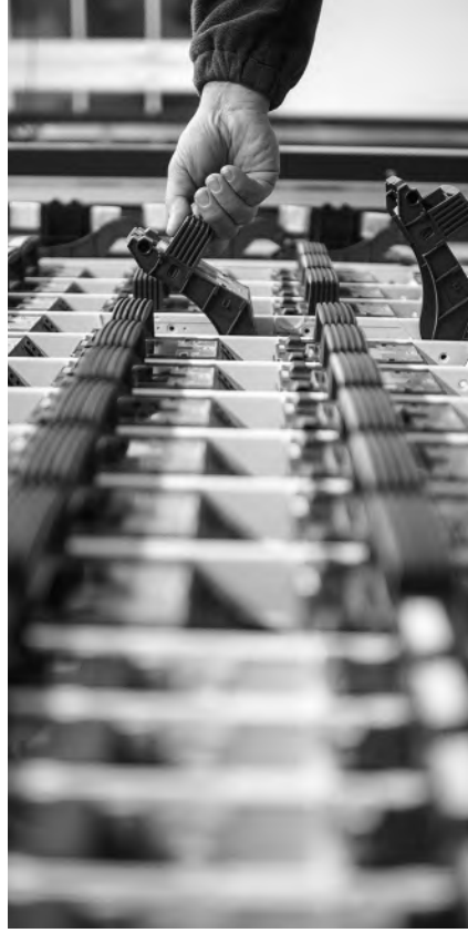
Herzstück der neugebauten Trafostation TS Salzhaus.
