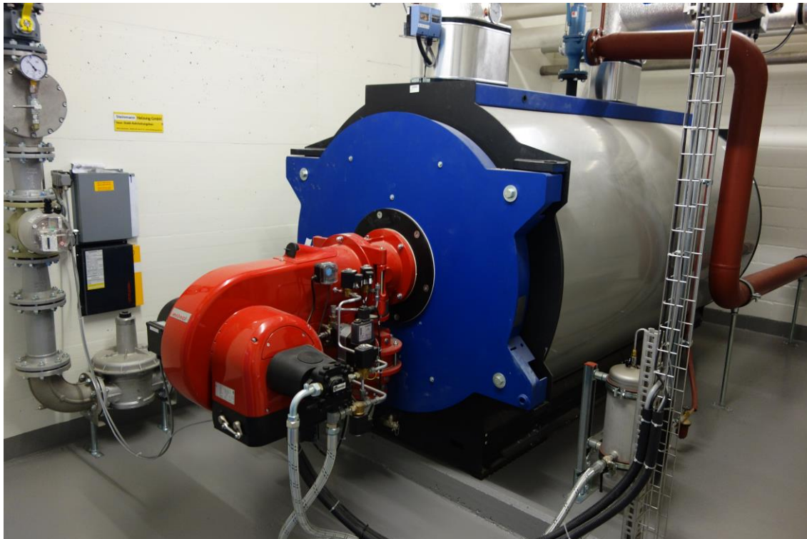
Neue Heizungsanlage 1'000 kW Wärmeleistung mit Kombibrenner Klärgas/Öl
